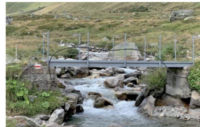
LE PONT MENAÇAIT DE S'EFFONDRE AVANT SA RÉNOVATION COMPLÈTE
