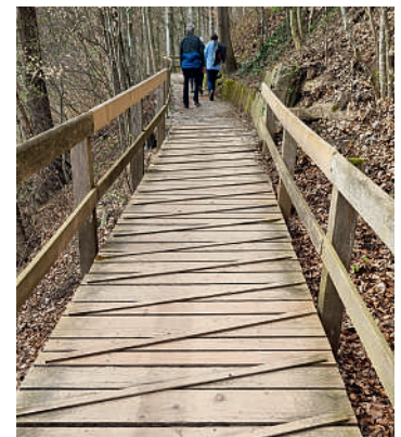
Abb. 70 Rutschfestigkeit der Gehfläche mittels schräg gestellter Hölzer
