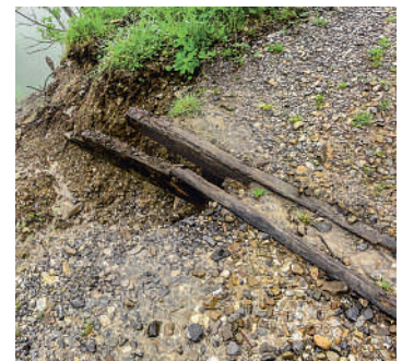
Abb. 118 Ungenügender Unterhalt Querabschlag
