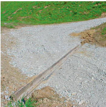
Abb. 39 Entwässerung im Wendepunkt
